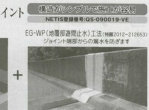
施工実績(29年9月末現在) 総延長1万5,289m(一般道路5,756m 高速道路9,533m)
